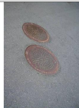
Figur 12 Kumlokk – det synlige i vegbanen. Kilde: FKB
